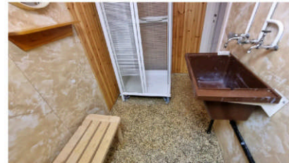
Overflater og sanitærinstallasjoner er av eldre dato.
