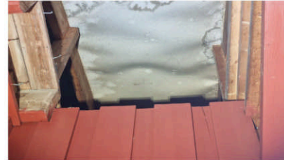
Fuktmerker og manglende luke.
