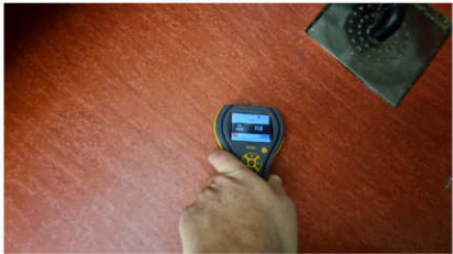
Det ble registrert forhøyde fuktverdier.
