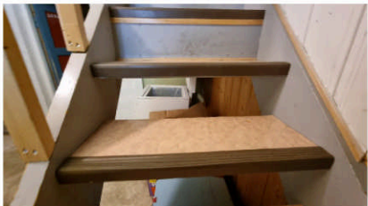
Åpninger mellom trinn i innvendig trapp er større enn dagens forskriftskrav (10 cm).
