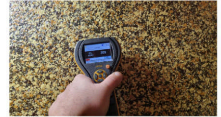
Det ble registrert forhøyde fuktverdier.
