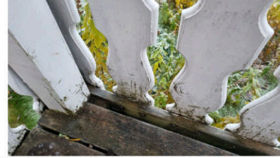
Rekkverket er noe værslitt.
