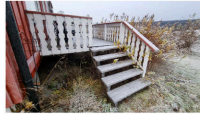
Det er ikke montert rekkverk på begge sider.
