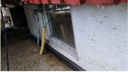
Vindu er værslitt
