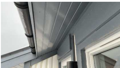
Manglende luftespalte/ventiler i raft.
