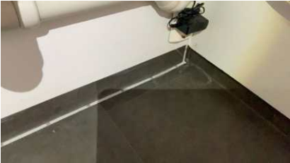
Aquastop monteret på vaskerom.
