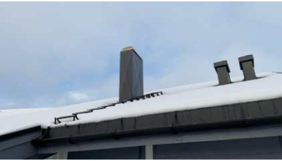
Det mangler snøfangere på hele taket.
