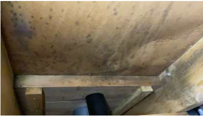
Undertak rundt gjennomføring for luftelyere.
