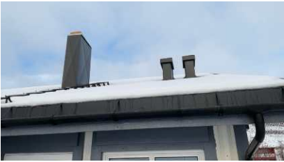
Det mangler snøfangere på hele taket.
