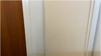
Mindre synlig skade på skyvedør.
