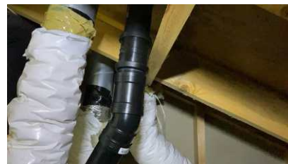
isolert ventilasjonskanal i raftekott.
