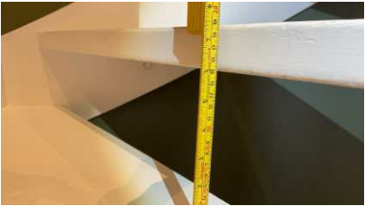
For stor åpning mellom opptrinn.
