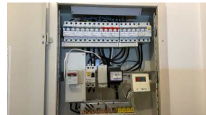
Sikringsskap med uatomatsikringer.
