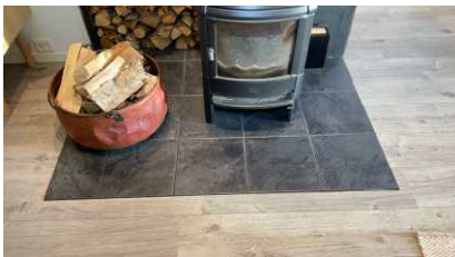
Bompuss og svekkede fuger i stue.
