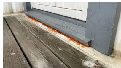
Ufagmessig utførelse i underkant verandadør.
