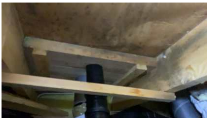
Fuktskjolder/-misfarging i undertak.
