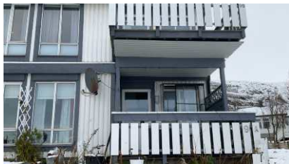
Markant synlig skjevheter i understøttende konstruksjon.
