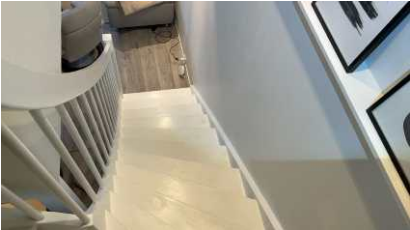
Håndløper mangler ned langs trappeløp.
