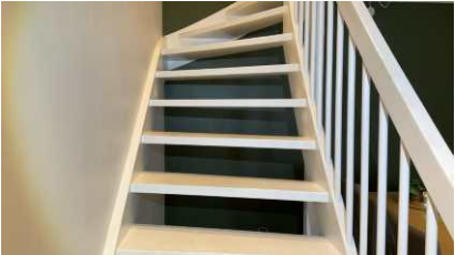
For stor åpning mellom opptrinn.
