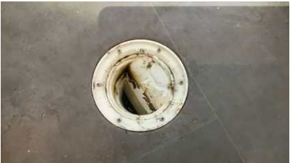
Plastsluk med klemring og synlig belegg.
