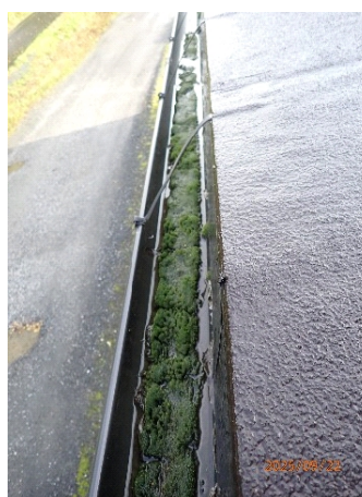
Takrenne er full av mose.
