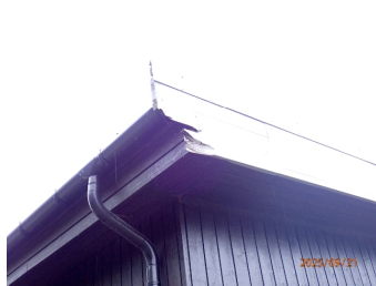
Takrenner og nedløpsrør av metall. Vindskibord er noe skadd etter påkjørsel ved snøbrøyting.
