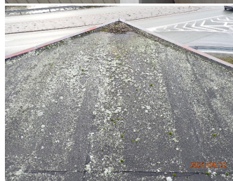
Papptekke er noe mosegrodd etter fugleaktiviteter og har enkelte luftblærer.
