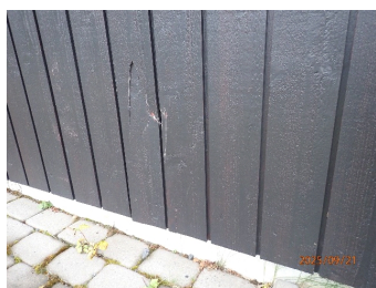
Liten skade på bordkledning etter påkjørsel.
