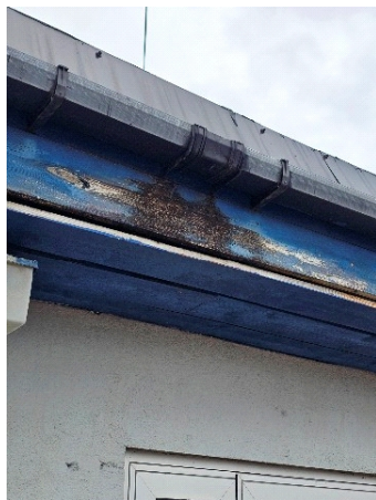
Lekkasje i takrenne
