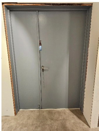
Brannør mellom utstilling og lager i kjeller
