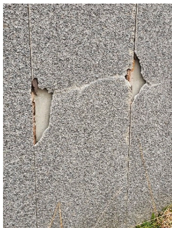
Skader i fasadeplater mot sør
