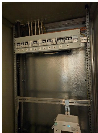
Sikringskap plassert i kjeller
