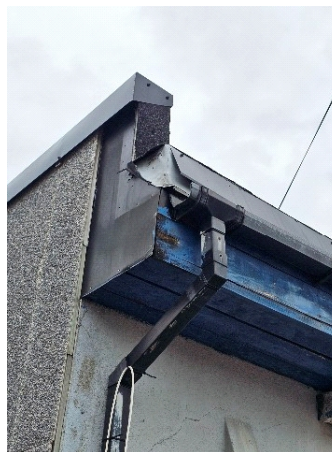
Manglende endelukk på takrenne
