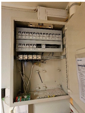
Sikringskap plassert på hovedplan.
