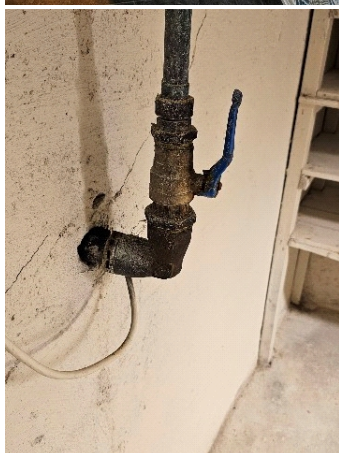
Vanninntak med utvendige rør i plast og innvendige rør i jern.
