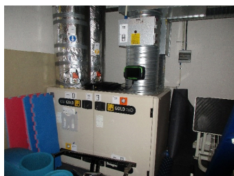
Ventilasjonsanlegg i kjeller
