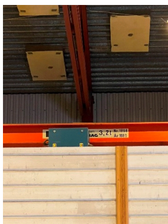
3,2 tonn traverskran fra 1985.
