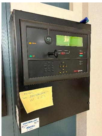
Moderne brannvarslingsanlegg med sentral.
