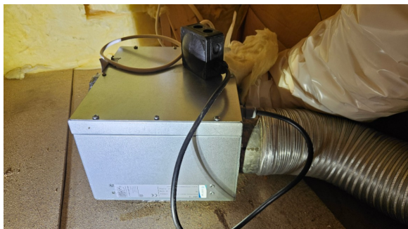
Mekanisk avtrekk fra våtrom.
