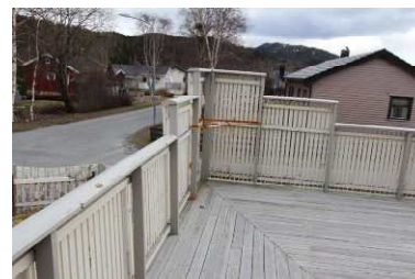
Skade på rekkverk i hjørne.
