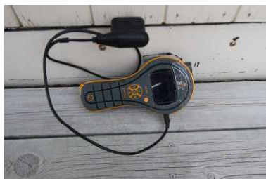
Fuktmåling i panel på balkongdøren
