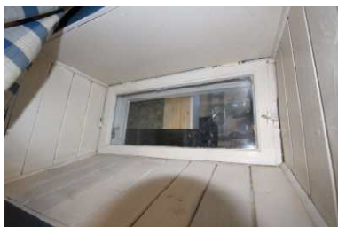
Sprukket glass i vindu.
