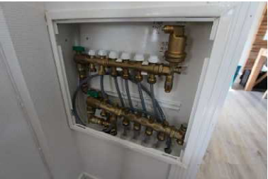
Fordelingsskap på stue.
