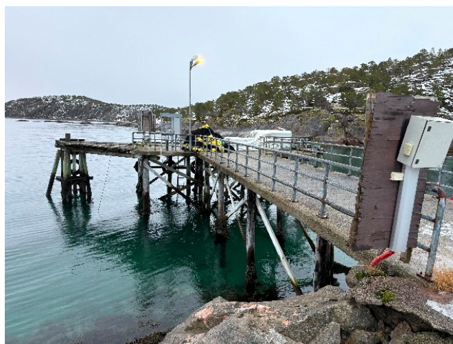
Kaianlegg, ukjent alder, fundamentet av trepilarer til sjø, dekke av betong for del av kai og gangbru til land.
