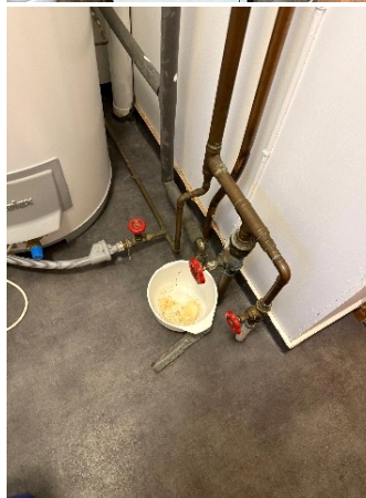
Hovedstoppekran. Tidvis drypplekkasje fra kran.
