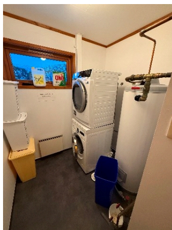
Vaskerom med bereder.
