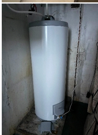
Varmtvansbereder plassert i kjeller.
