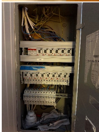
Sikringskap. kuresfortegelse magler.
