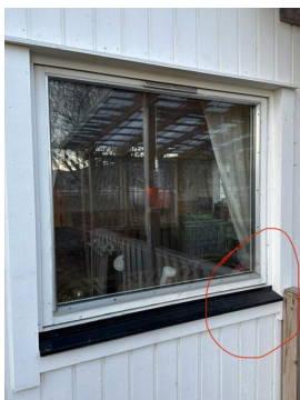
Beslag er lagt utenpå og mot vindu, feil utførelse.
