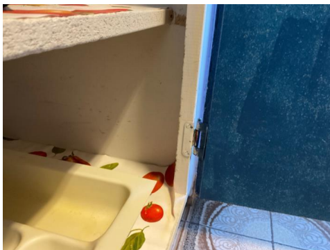
Skade på kjøkkeninnredning.
