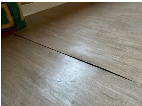
Slitt/skadet gulvflate i 1 etasje.
