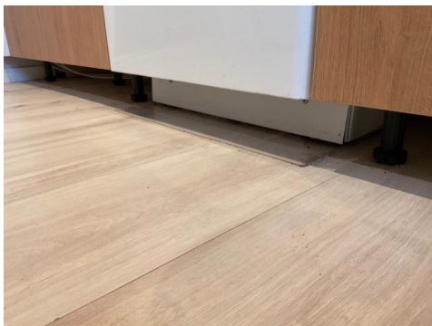
Manglende sokkel på underskap.
