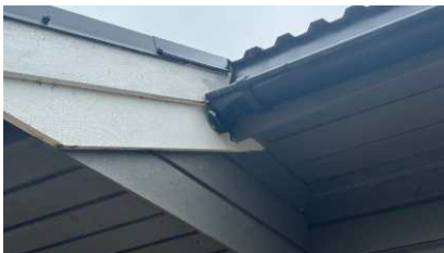
Takrenner har punktvis lekkasjer.
