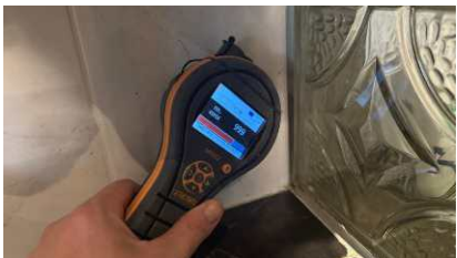
Det er målt forhøyede fuktverdier på gulv og vegger i dusjonen.
