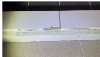
Det er påvist sprekker i fliser.
