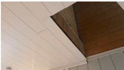
Noe gjenstående arbeider.
