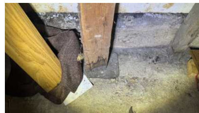
Det er registrert noe fuktskader på treverk i trappekott.
