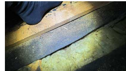
Det er registrert spor etter skadedyr/mus.
