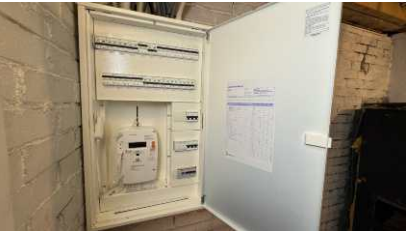
Kontroll av el-skap og kursfortegnelse.
