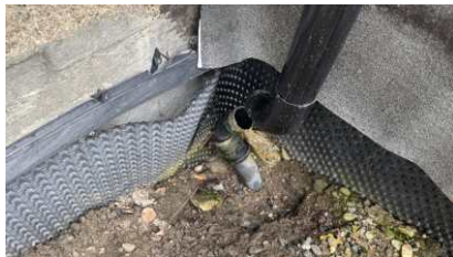
Grunnmursplast er ikke tilfredsstillende flere steder.
