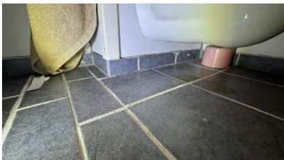
Manglende dreinsåpning under den innebygde sisternen.
