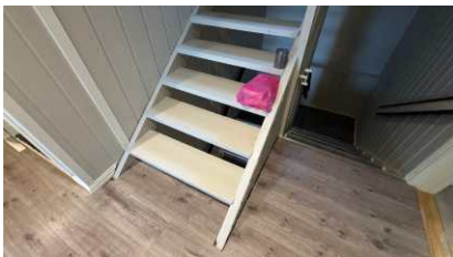
Det er ikke montert rekkverk i nederste del av trappen.
