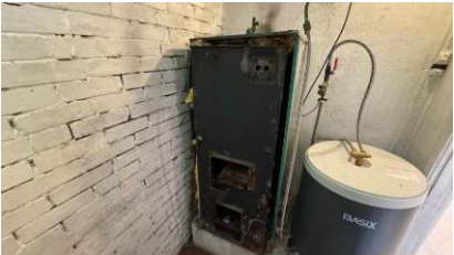
Fyringsanlegget er delvis demontert.
