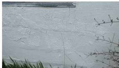
Det er registrert sprekkekanaler i muren.
