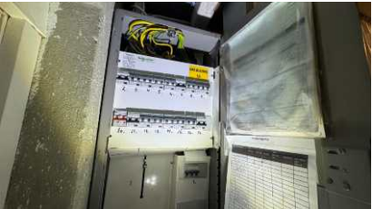
Kontroll av el-skap og kursfortegnelse.
