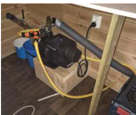
Trykkvannpumpe med stoppekrane i uthus.
