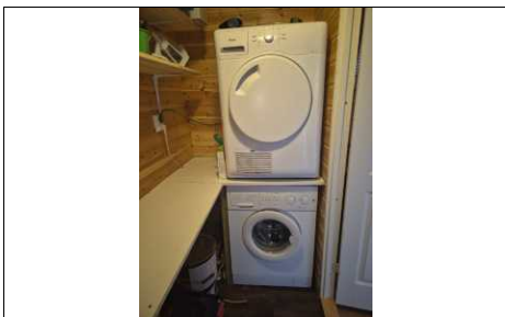
Vaskemaskinen er plassert i uthuset.
