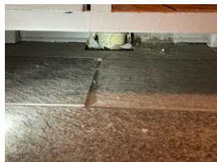
Utett gjennomføring under servant.
