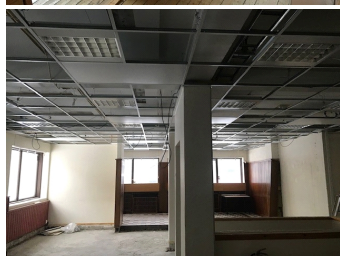
Tregulv fjernet i 1.etg
