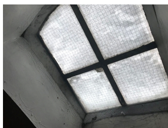
Levetid er utgått for vinder og dører
