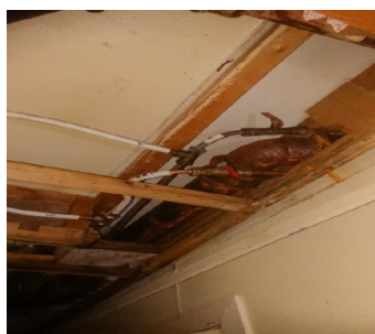
Forskjellige alder på rør.
