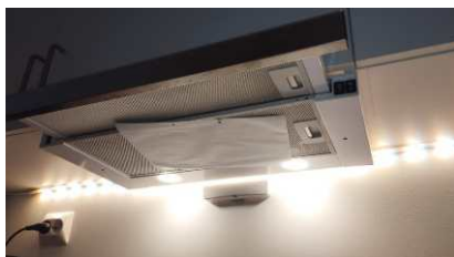
Funksjonstest av avtrekk.
