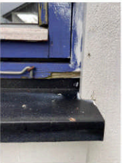
Skade på vinduskarm på veranda.
