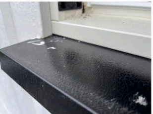
Vannbrett helt opp under karm og omramming uten luftspalte
