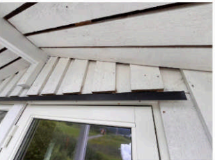
Unøyaktig tilpasset kledning rundt vinduer.
