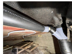
Vannrør i kryperom, frostsatt.
