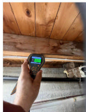
Fuktnivå i trebjelkelag er normalt med tanke på at det ligger under terreng og har liten utlufting.
