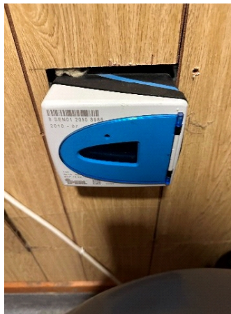
Vannmåler plassert i vaskeri.
