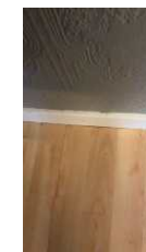
Mindre glipper mellom listverk og gulv overflater
