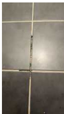
Bom og dype fuger samt dårlig festede fliser
