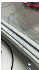
Tegn til kodens skader på vinduer i stue.
