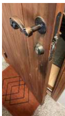
Generell brukslitasje på overflater og karmen
