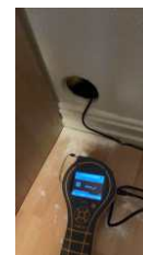
Det måles ikke forhøyede fuktverdier ved hullboring
