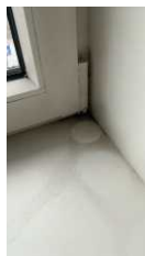
Kaldtrekk fra vinduer på kjøkken
