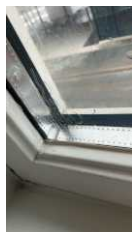
Svekkelse i gasslaget mellom glassene
