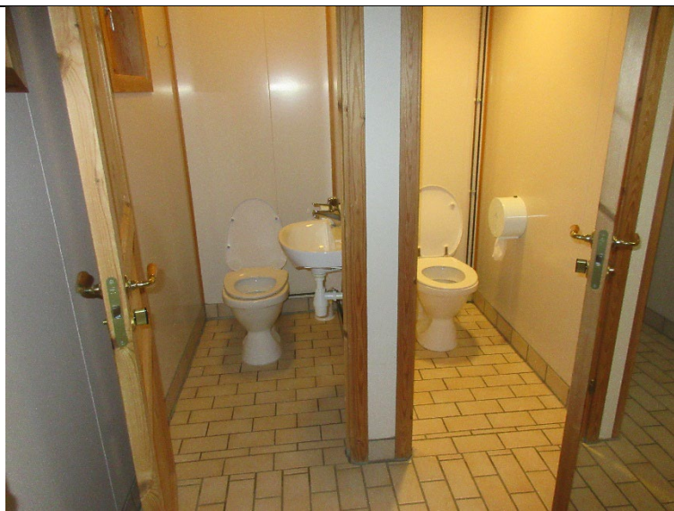
Bilde 31: Toaletter med WC og HV.
