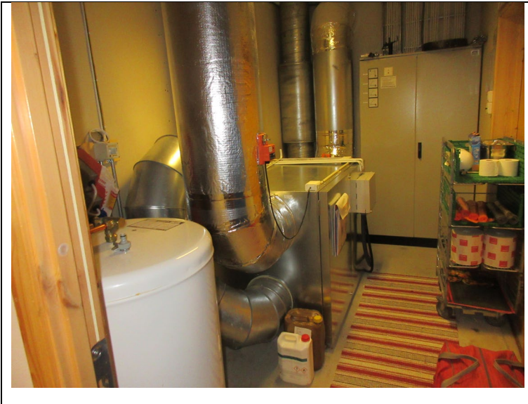
Bilde 15: Teknisk rom.
