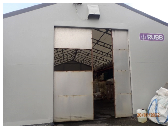
Slitt og skadd port.
