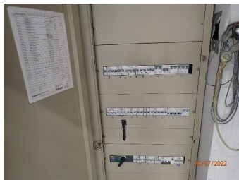
El. skap i 2. etasje.
