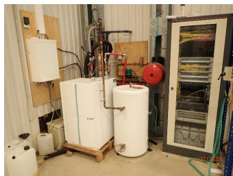
El. kjele og varmtvannsbereder.
