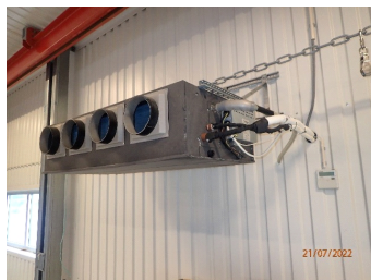
Innedel luft til luft varmepumpe.
