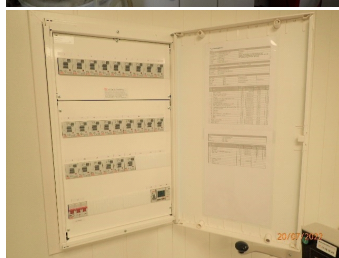
1. etasje: El. skap med jordfeilautomater.
