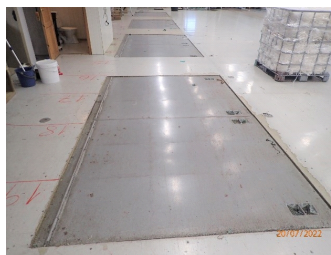
19 luker av stål i etasjeskille/gulv 2. etasje.
