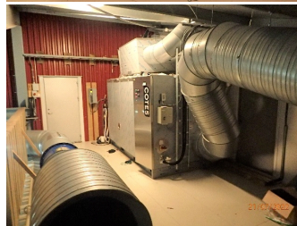
Mesalin/teknisk rom i tilbygget impregnering/tørkehall.
