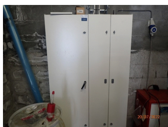
Underetasje: El. inntaksskap.
