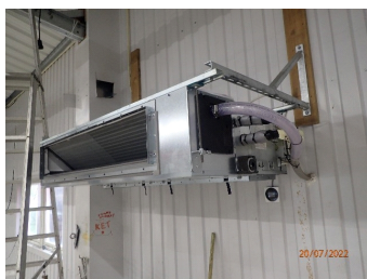
Innedel luft til luft varmepumpe.
