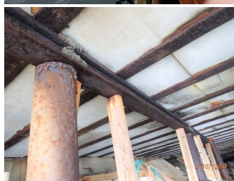
Rustangrep på borerør og jernbanesviller (under kaidekke).
