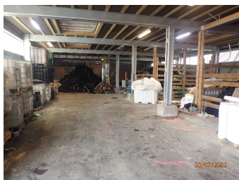
Støpt gulv i 1. etasje - område med setninger.
