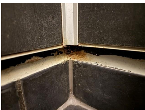
Mellomrom mellom sokkel-flis og baderomspanel.
