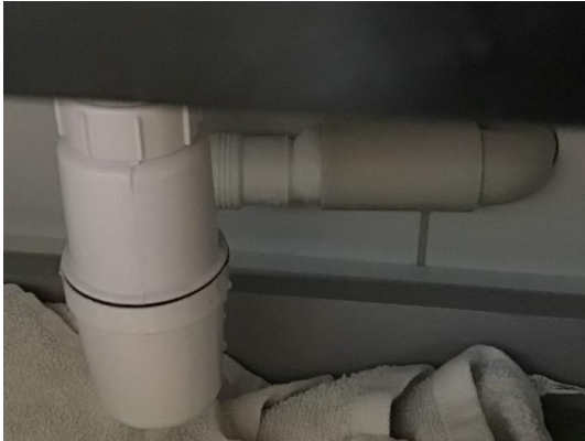
Drypping fra avløp
