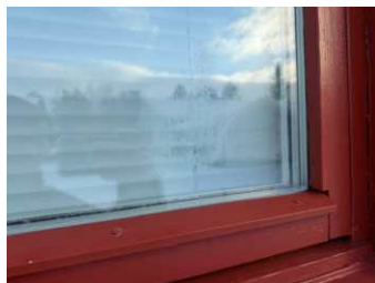
Punktert vindu i soverom mot vest i 1.etg.
