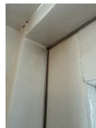
Kaldtrekk i balkongdør 1.etg, pakning ikke er ikke tett.
