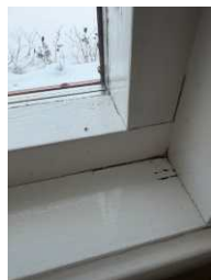
Stue vinduer har noe fuktskader.
