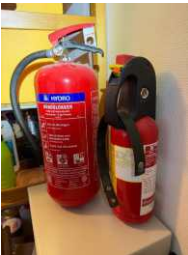
Brannslukker er over 10 år og må byttes.
