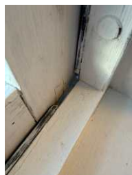
Vindu har noe slitasje og pakning er ikke tett.
