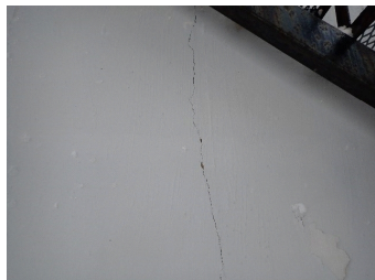
Vertikal sprekk i murvegg
