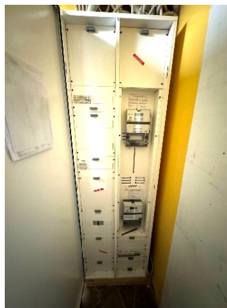
Skap med målere i kjeller.
