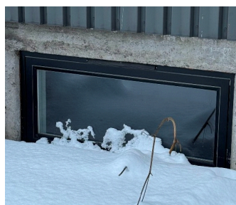
Det mangler beslag rundt kjellervindu.
