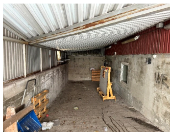
Noe bul på bakre del av konstruksjon/plater i tak.
