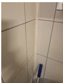
Ikke fagmessig utført fuge i hjørner.
