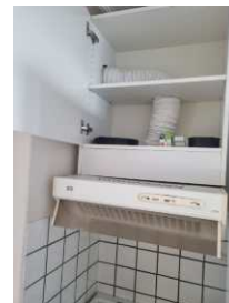
Avtrekksvifte med avsug ut gjennom pipeløp
