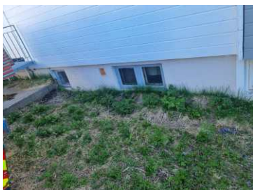
Terreng faller inn mot bygningen.
