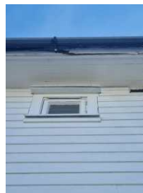
Forhold som er forenlig med råteskadet treverk.
