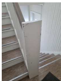
Trapp bærer preg av slitasje og sårskader.
