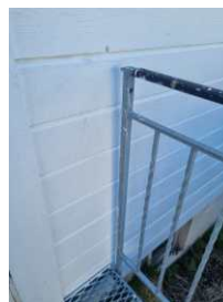
Rekkverk er ikke festet tilfredsstillende.
