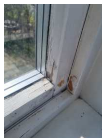
Spor etter innvendig kondensering.
