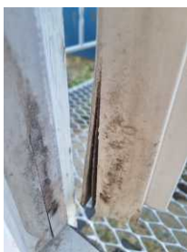
Tydelige tegn på fuktskader og løst laminering.
