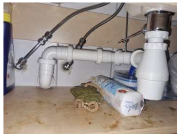
Avløpsrør under servant på badet.
