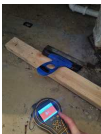
Utslag på fuktmåler på betonggulv vaskerom.
