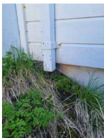
Vann ledes ikke bort fra bygning ved nedløp.
