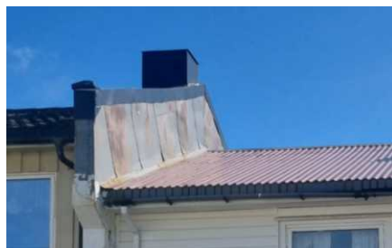
Rust på beslag.
