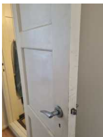
Løs dørvrider og generell slitasje.
