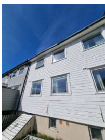
Takrenne på nedsiden er knekt i skjøt
