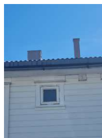
Takrenne på inngangssiden har deformasjoner.
