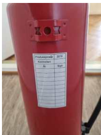
Manglende service på brannslukker.
