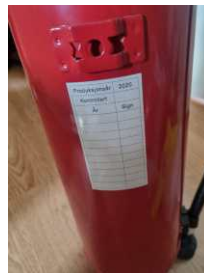
Manglende service på brannslukker.
