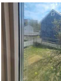
Det er påvist noen glassruter som er punktert eller sprukket.
