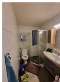
Dusjsone er innestengt av en bunnprofil.
