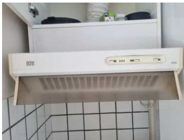
Avtrekksvifte av eldre dato.
