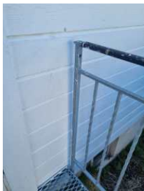
Manglende innfesting av utvendig trapp rekkverk.
