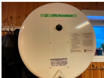
Veggmontert varmtvannstank i garderobe.
