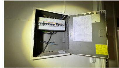
Kontroll av el-skap og kursfortegnelse.
