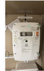
Måler plassert i felles skap i parkeringskjelleren.
