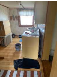
Innredning flyttet fram fra vegg grunnet vannlekkasje
