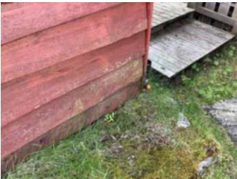
Råteskadet utv kledning
