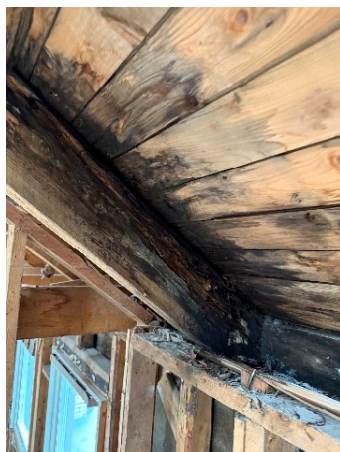
Råte i konstruksjon.
