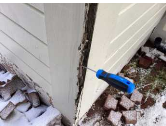
Eksempel på råteskadet kledning
