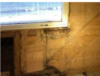
Eksempel på råteskadet konstruksjon
