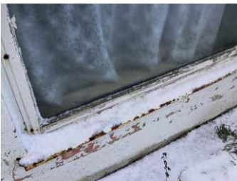
Eksempel på vindu som preges av elde og slitasje.
