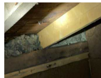
Eksempel på manglende lufting
