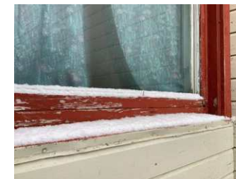
Eksempel på ufagmessig utførelse av be slag
