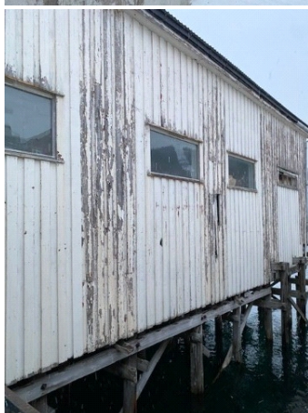
Råte og slitt kledning
