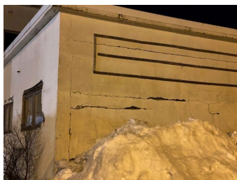
Sprekker i mur
