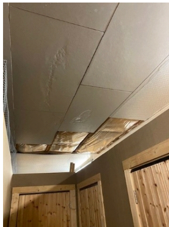
Merker etter lekkasjer
