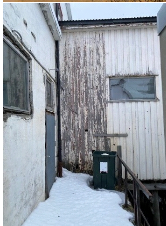
Råte og slitt kledning
