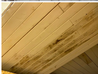
Merker etter lekkasje
