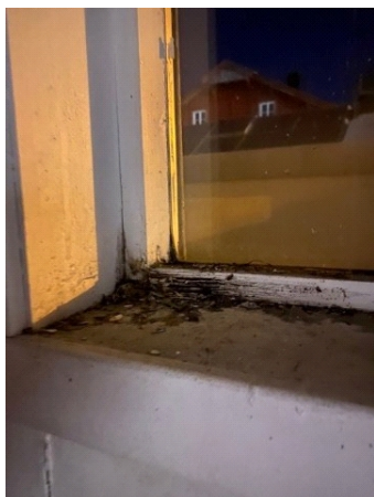
Råte i karm
