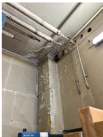
Lekkasje i bakkant av lagerhall.
