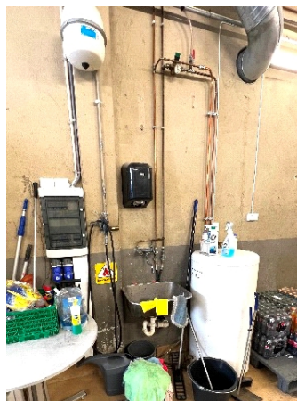
Utslagsvask og bereder i lagerhall.
