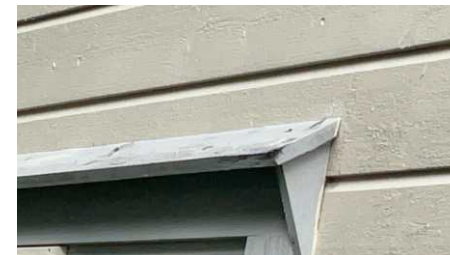
Råteskade i vannbord
