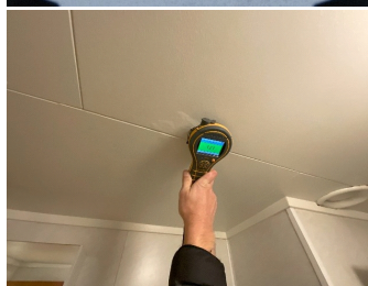
Fuktsøk på bad i 3 etasje
