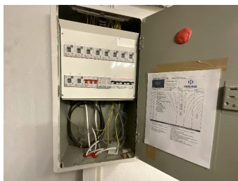
El. anlegg med skap i begravelsesbyrå
