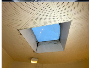
Det er lekkasje omkring takkuppel
