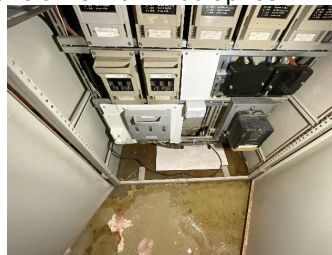
Hovedsikringer, og grunnvannspumpe under.
