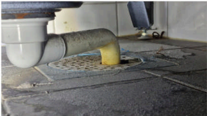
Noe begrenset mulighet for inspeksjon av sluket på grunn av dusjkabinettets plassering og manglende rengjøring av sluket.
