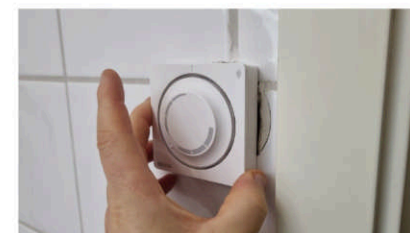
Termostaten for vannbåren varme på badet fremstår noe løs, og er ikke plassert slik at den dekker hele åpningen som er utsparrert i flisene.
