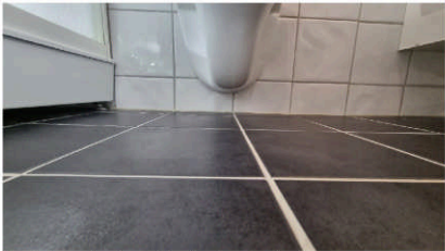
Manglende dreneråpning under den innebygde sisternen.
