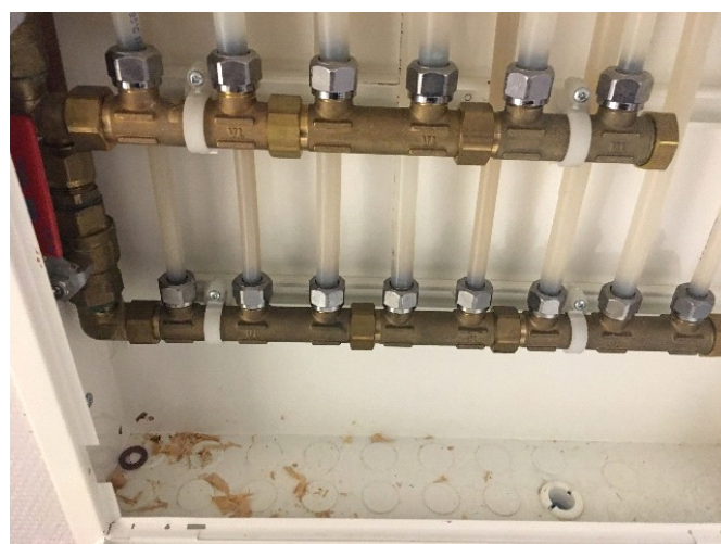
Rør i rør skap.
