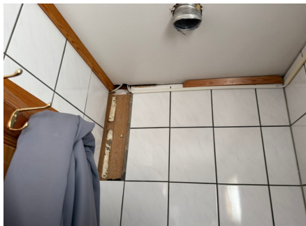
Skader på vegg fliser og ingen tegn til membran
