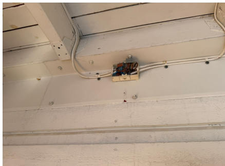
Åpen koblingsboks utvendig
