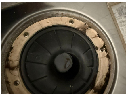
Ingen tegn til membran rundt sluk eller rørføringer
