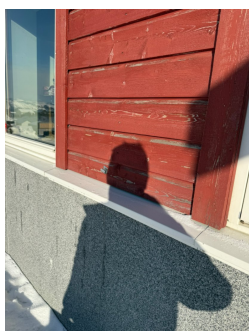
Det er værslitt/oppsprukket trevirke/trepaneler.
