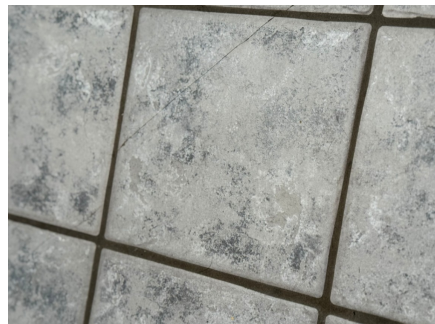
Skader på gulvfliser
