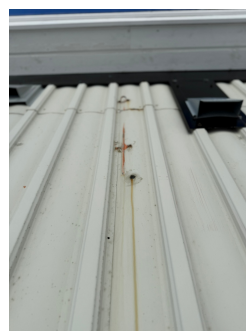
Mindre skader i stålplater samt rust stedvis
