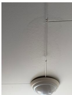
Tegn til tidligere fuktskader i takplater
