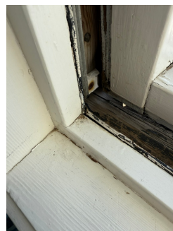
Det er påvist at enkelte vinduer er vanskelig å åpne/lukke.
