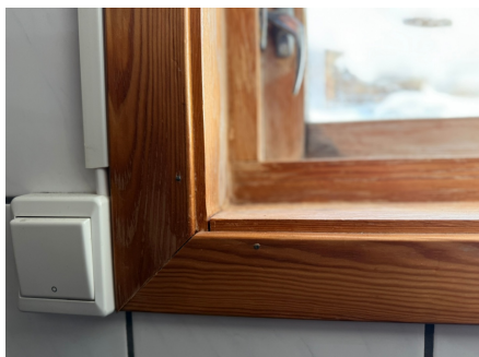
Antydning til innvendig kondensering på enkelte glass
