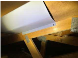
Deler av undertak er tettet med blikkplater.
