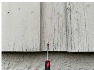
Sprede råteskader, hovedsak mot sørøst
