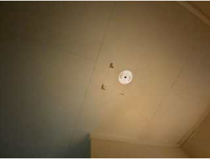
Ingen belysning i rommet.
