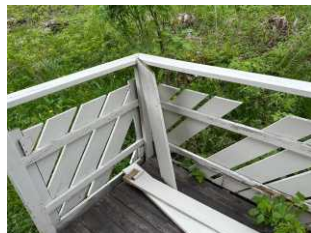
Mangler rekkverksbord og råteskader i rekkverk.
