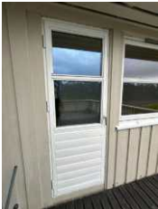
Balkongdør soverom, karmen og dør er slitte og det er sprekker i treverket.
