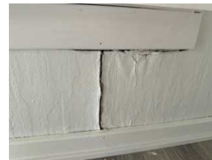
Fuktskader i veggplater under vindu på stue.
