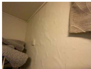
Tapet er stedvis løst fra underlag.
