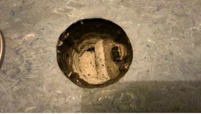
Ikke tett mellom sluk og beleg.
