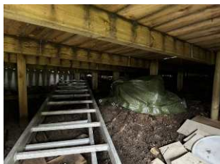
Dårlig fundamentering av balkong og terrasse.
