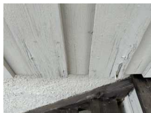
Sprede råteskader, hovedsak mot sørøst
