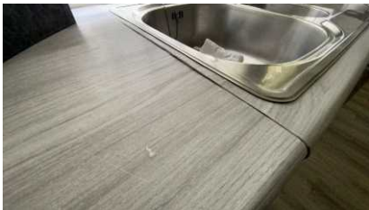
Fuktskade i benkeplate.
