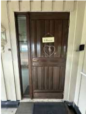
Hovedytterdør, skade på pakning.
