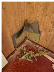
Råteskade mot bad og yttervegg
