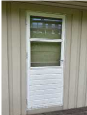
Balkongdør kjøkken, karmen og dør er slitte og det er sprekker i treverket.
