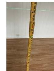
Soverom 96,6cm, avvik på 10mm målt i en diameter på 2m.
