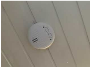
Brannvarsler i underetasje er tom for batteri
