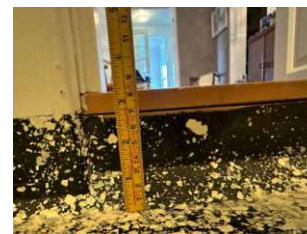
Oppkant ved dør ca. 6cm.
