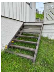
Trapp til balkong mangler rekkverk.
