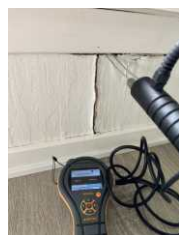
Fuktskader under vindu på stue mot nord. Ingen utslag ved bruk av fuktindikator.
