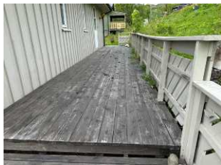
Skjevhet i rekkverk og terrasse.
