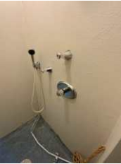
Fukt og råteskader på veggplater i dusjnise.
