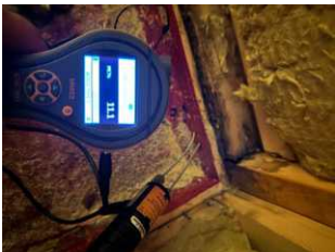
Synlig råteskade i badstu mot bad.
