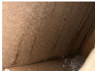
Synlig gammel skade i vegg.
