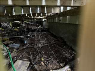
Fall mot grunnmur under terrasse.
