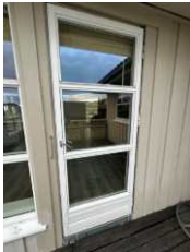
Balkongdør stue, karmen og dør er slitte og det er sprekker i treverket. Et sprukket glass med dugg.
