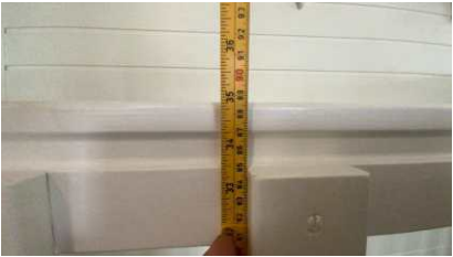
Høyde på rekkverk 89cm.
