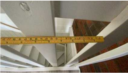
Åpninger på 11cm i rekkverk
