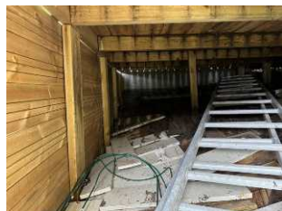
Dårlig fundamentering av balkong og terrasse.
