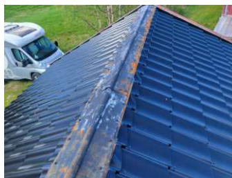
Rust på mønekam over eldre del.
