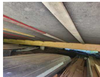
Pilarer av telefonstolper under tilbygd hytte.
