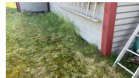
Kledning er for nært bakkenivå.
