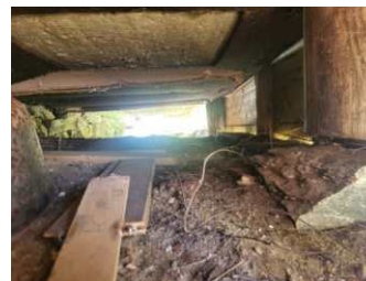
Asfaltplate har løsnet under bjelkelag i inngangspart.
