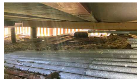
Brudd i overløpsrør under hytta.
