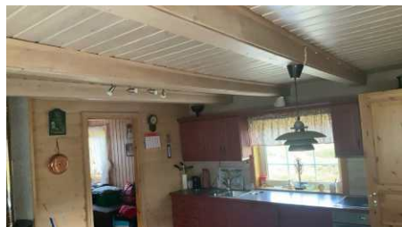
Nedbøying i bjelker på kjøkken.
