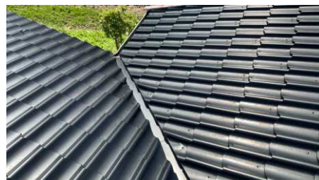
Enkelte bungler i takplater
