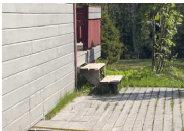
Det er ikke montert rekkverk.
