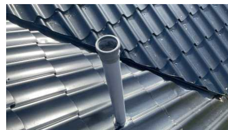
Lufteør ut over tak er kun utvendig fuget.
