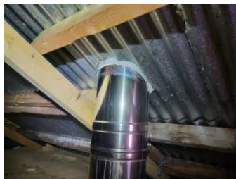
Gjennomføring røykrør gjennom tak.
