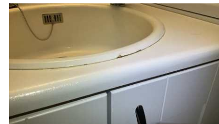
Sprekk i kant på servant.
