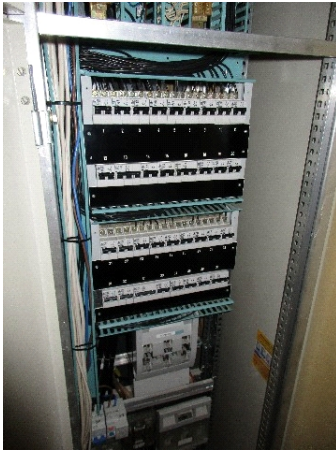
Hoved skap i teknisk rom
