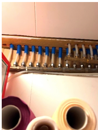
Rørfordeling i teknisk rom.
