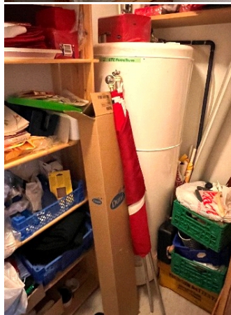
VVB plassert i teknisk rom/bøttekott.
