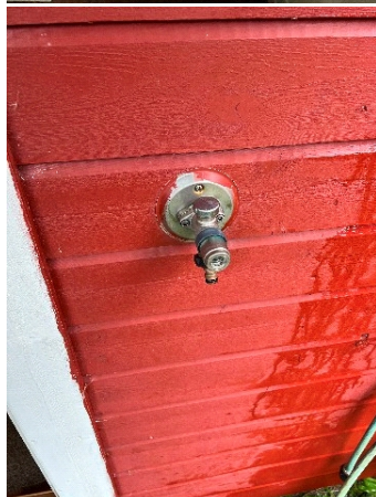
Utvendig tappekran for vann.
