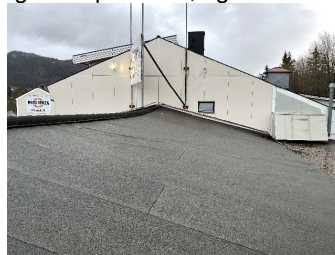
Skade på takkonstruksjon i mellombygg nr 20
