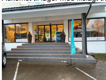
Inngangsparti til nr 20 - skadet fliser i trapp
