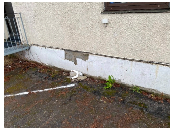
Nr. 18 sprekker på mur, avskalling
