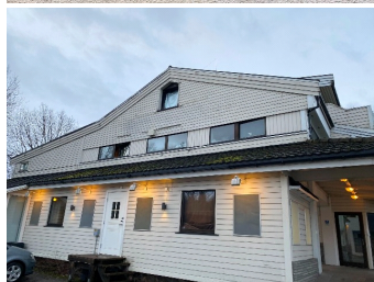
Nr. 22 Bordkledning, stedvis noe slitt og spredte råteskader
