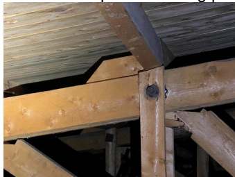
Skade på takkonstruksjon i mellombygg nr 20
