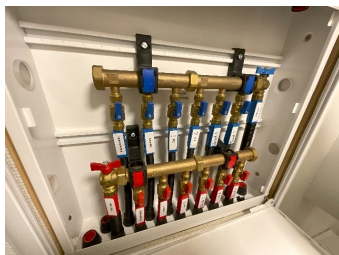
Rør i rør opplegg til bad og kjøkken i nr. 18
