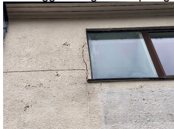
Nr. 18 sprekker omkring vindu
