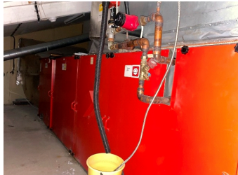
Nr. 22 eldre ventilasjonsanlegg
