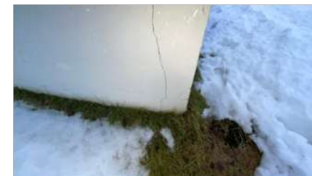
Sprekk i grunnmur
