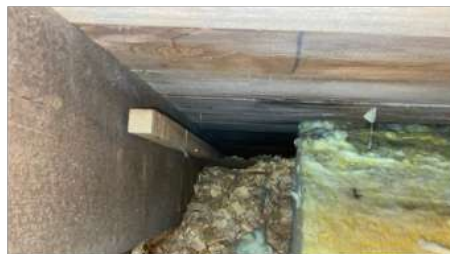
Luftespalte mot raft (ikke synlig i "strekningen" mot raft/raftekasser)
