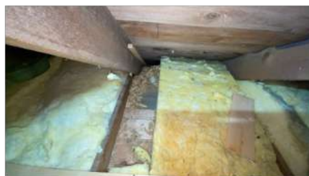
Manglende og varierende utførelse av isolering i loftet
