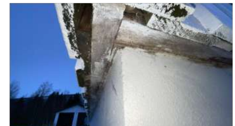
Manglende musesperre. Åpninger > 6 mm
