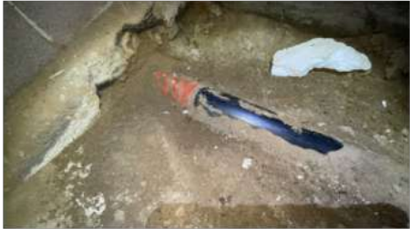
Overgang mot utvendig plastrør
