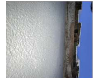
Manglende/mangelfull behandling av bordkledningens endeved
