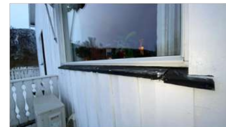
Omramming avsluttet for nær beslag og manglende innfesting av beslag
