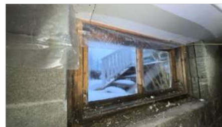
Høy fuktighet med råte i kjellervindu
