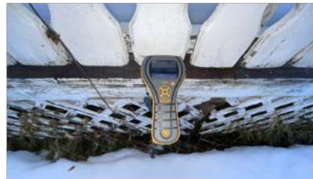
Fukt og råte i rekkverk, fuktquote 23,8 %
