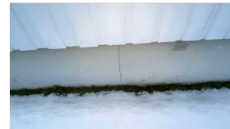
Sprekk i grunnmur
