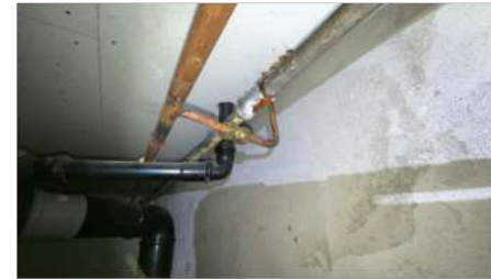
Rust på jernrør
