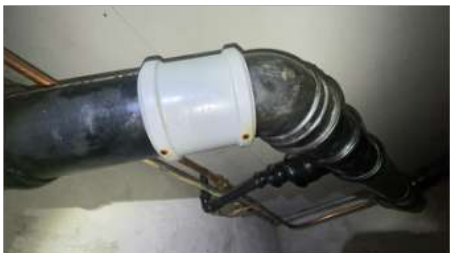
Lekkasje fra avløpsrør ifbm rørskjøter
