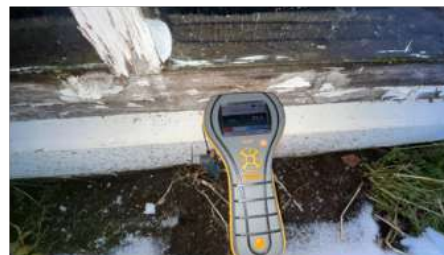
Fukt og råte i konstruksjon, fuktquote 39,9 %
