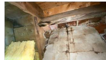
Rennemerker etter sotvann i kaldloft
