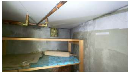
Tett ventil i kjeller
