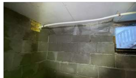
Høy fuktighet på takplater i bod
