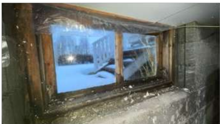
Råte i kjellervinduer
