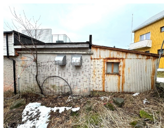
Rust og hull i fasadeplater mot baksiden.
