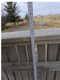
Rekkverk ved inngang er ca 90cm
