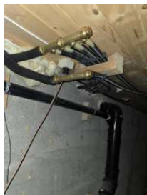
Fordelerstokk i himling i krypekjeller
