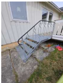
Åpninger i rekkverk er ikke i hht dagens krav
