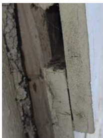
Manglende smådyrsperre bak bordkledning
