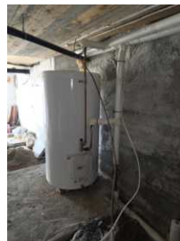
Saltutslag på vegg bak vv-bereder
